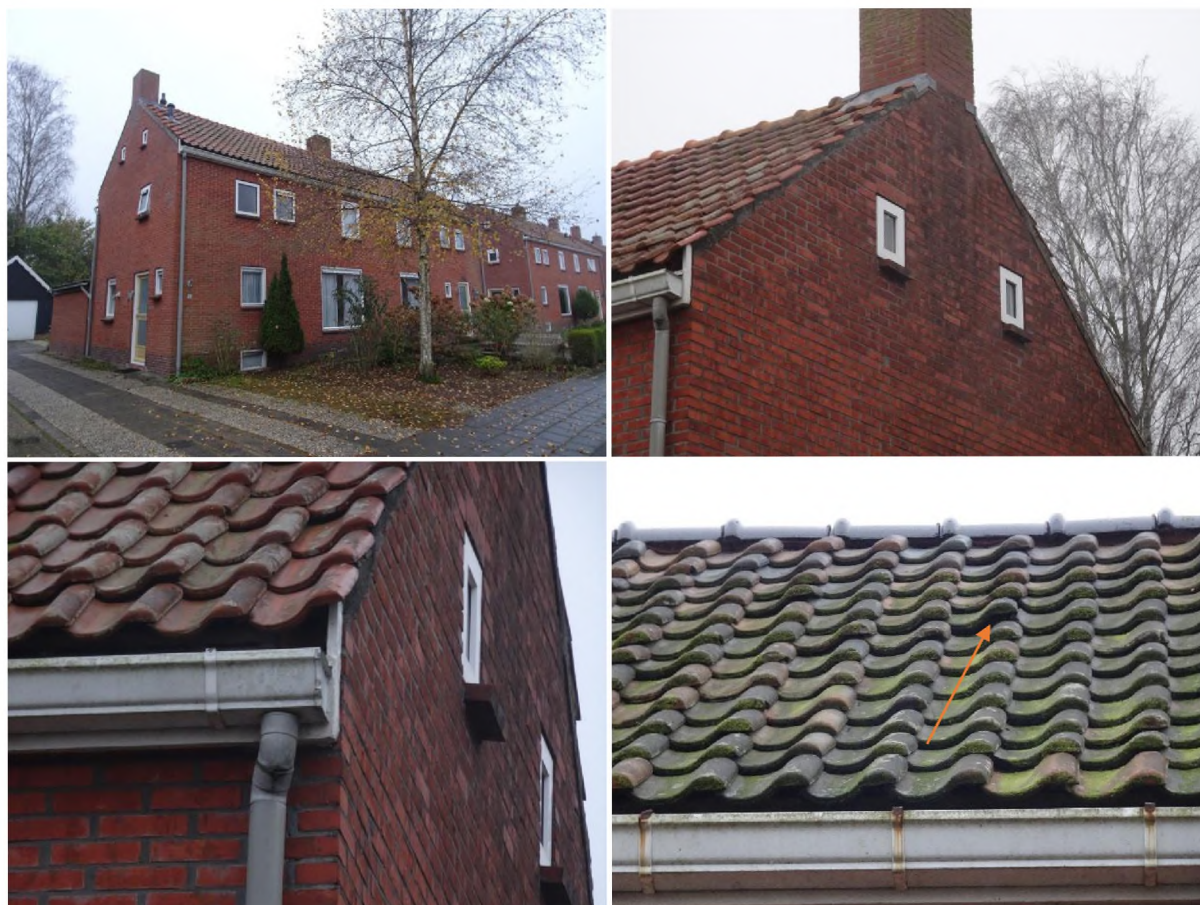
Figuur 19 Actuele situatie in de Molenstraat te Marum (even huisnummers) op 11 november 2021. Linksboven: overzichtsfoto van twee van de woningblokken. Rechtsboven: voorbeeld van een van de kopgevels. De kantpannen liggen volledig in het cement en bieden dus geen invliegopeningen voor vleermuizen dan wel gierzwaluwen. Linksonder: de hoek van de dakgoot biedt ruimte voor gierzwaluwen om binnen te vliegen. De rest van de dakgoot lijkt ook geschikt voor huismussen om zich een weg onder de dakpannen te verschaffen. Rechtsonder: voorbeeld van een scheefliggende dakpan die een invliegmogelijkheid verschaft voor vleermuizen en mogelijk gierzwaluwen.
