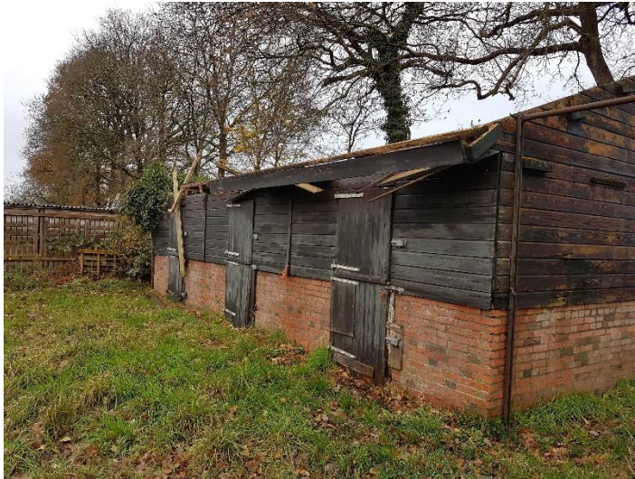
Foto 5 De schuur is in verval- len staat, heeft geen spouw en geen dak en daarom ongeschikt als verblijfplaats voor vleermuizen.
